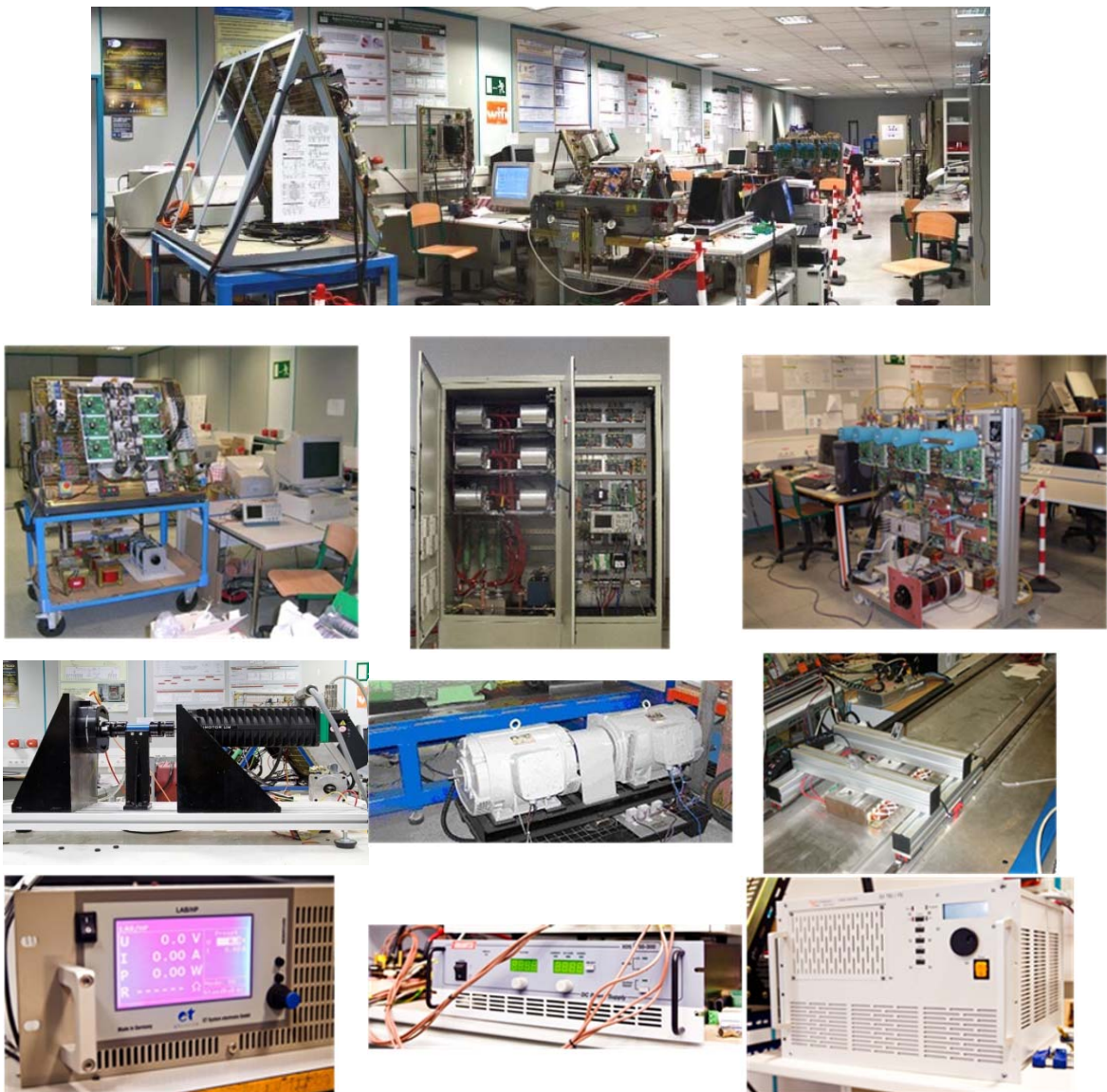
Figura 4. Foto del laboratorio de baja tensión.
